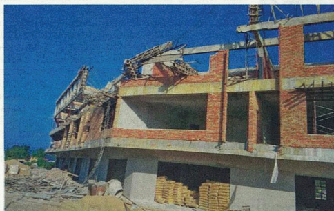
TAPAK pembinaan rumah kedai yang struktur konkritnya runtuh dan menghempap dua pekerja di Machang semalam.
