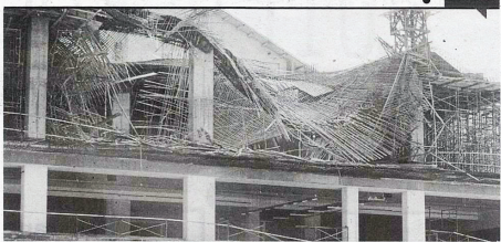
Kadaan sebahagian struktur bangunan kilang yang dalam pembinaan runtuh di Bayan Lepas, Pulau Pinang, semalam. [FOTO RAMDZAN MASIAM/BH]
