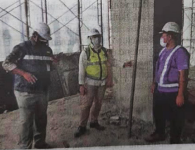
Pengarah Jabatan Keselamatan dan Kesihatan Pekerjaan WP Kuala Lumpur dan Putrajaya, Ir. Zamzurin Maarof (di kiri) meninjau lokasi laluan dan pengawal keselamatan maut dihempap batang besi.
